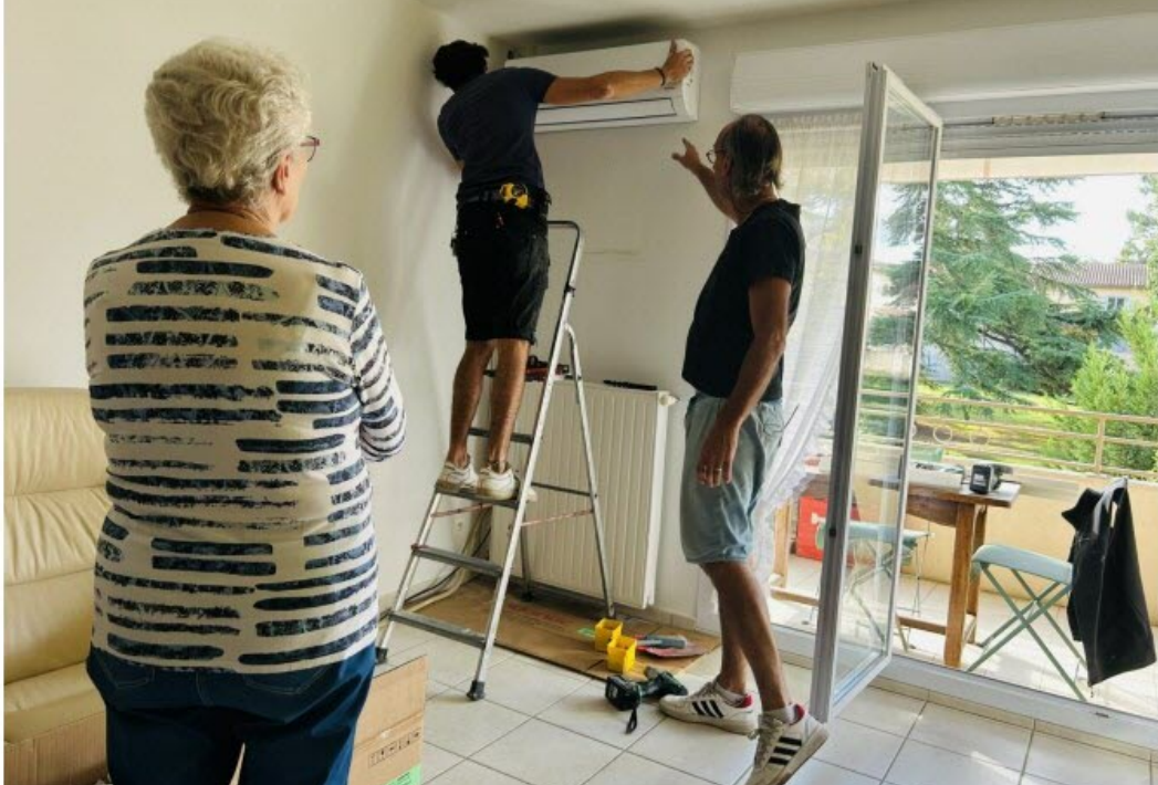
Les climatiseurs permettent de rafraîchir un logement, mais sont soumis à de nombreuses normes d'installation. Photo Yoann Terrasse
